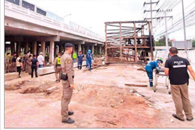
▲ พระราม 2 อีกแล้ว : เกิดเหตุบั้งขึ้นลอคเสาเข็มล้มทับคนงานเสียชีวิต 1 คน บริเวณถนนพระราม 2 ซอกถนนวิภาวดีรังสิต (ช่วงยูเทิร์นสะพานคลองหลวง) จ.สมุทรสาคร โดยเจ้าหน้าที่ตำรวจ สภ.บางโพธิ์ ได้สั่งปิดการจราจรเพื่อเคลียร์พื้นที่ และเคลื่อนย้ายร่างผู้เสียชีวิตออกจากที่เกิดเหตุ
