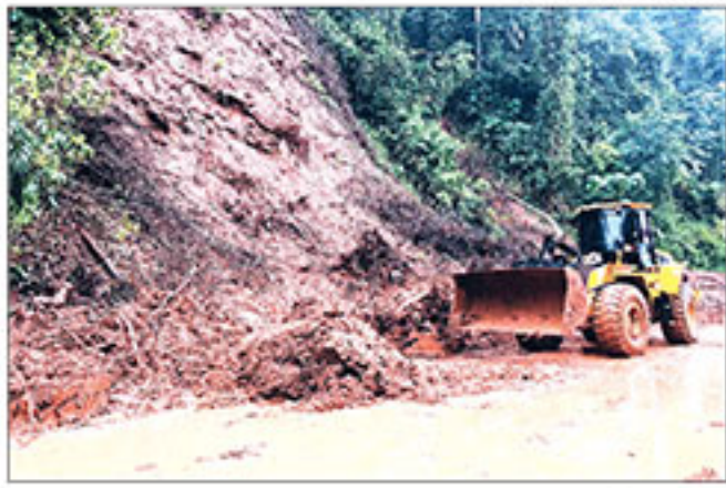
▲ ดินสไลด์ปิดทาง : เกิดเหตุดินสไลด์ทับเส้นทางสัญจร ในพื้นที่ กม.7 บ้านทรายไม้แก้ว เมล่ง ๕.๒๕๖๓ เนื่องจากฝนตกต่อเนื่อง ขณะที่กรมทางหลวงชนบทจะเอา และอบค.คานาจะแนะนำ เร่งนำเครื่องจักร เครื่องมือ รถบรรทุกไถลงพื้นที่เพื่อเคลียร์เส้นทางและพร้อมรับรถบรรทุกเข้าเขตชั้นลาด 24 ชม.
